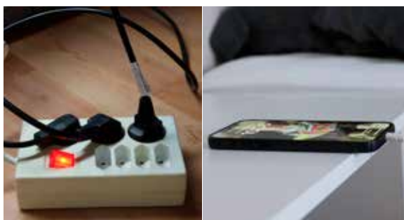
Skjøteledninger og «padder» med mange tilkoblinger bør unngås. Mobiltelefonen til lading på nattbordet skal ikke skje. (Begge foto: Ove Hansrud)
