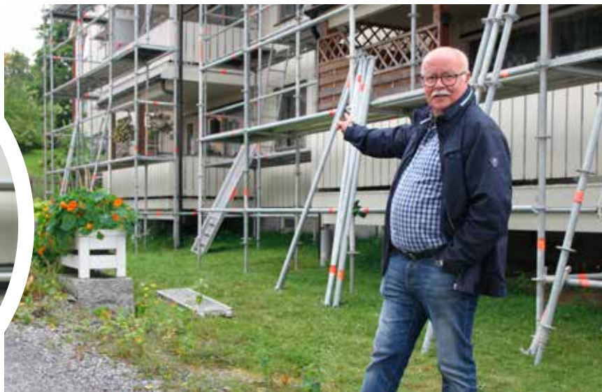
I borettslaget Alfsgate/Torggaten skal vinduer og tak skiftes ut. Brannsikringen blir fornyet, og beboerne får også større verandaer å boltre seg på, forteller Stig Fonås.
