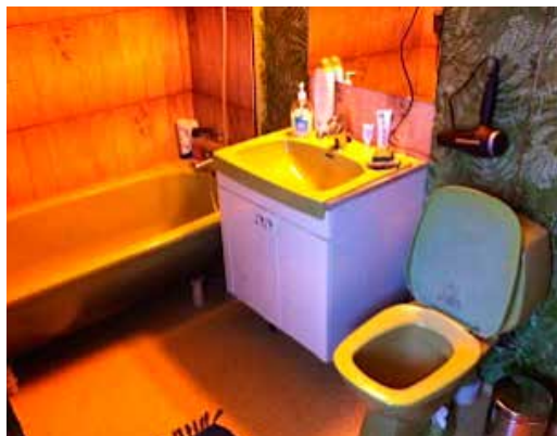
FØR: Slitt bad fra 80-tallet, som forlengst trengte oppussing.
