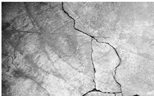
Følg med på sprekker i grunnmuren.
